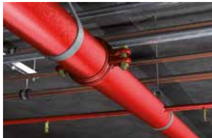
Sistemas contra incendio
