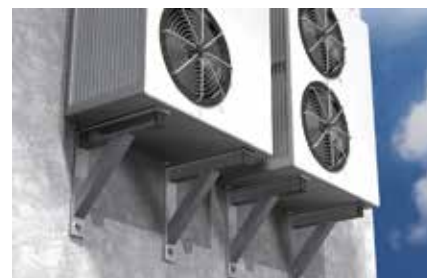
Ménsulas para unidades de aire acondicionado
